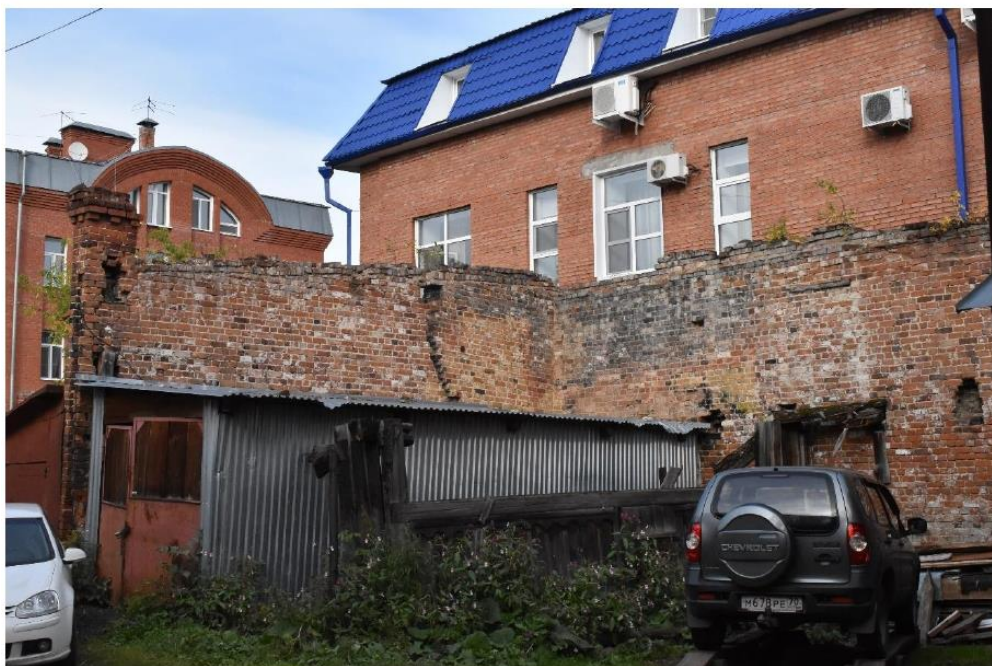
Рис.16 Брандмауэр между хозяйственными постройками на ул. Трифонова, 10а. Автор съемки: Голендухина Е.А.; 15.09.2020г.
